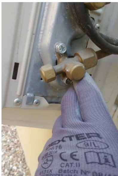
Détection d'une éventuelle trace d'huile sur la tuyauterie d'aspiration. © AFF.
