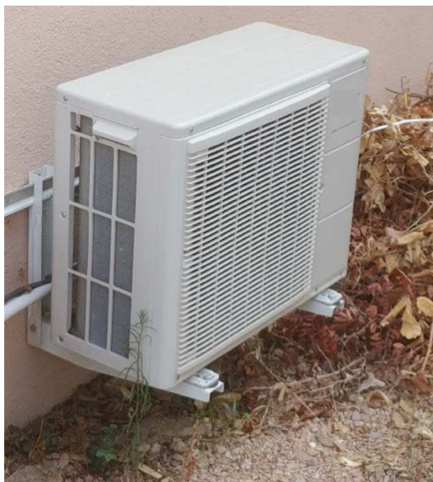
Débris de végétaux pouvant affecter l'unité extérieure. © AFF.
