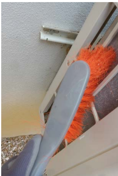
Nettoyage de l'unité extérieure. © AFF.
