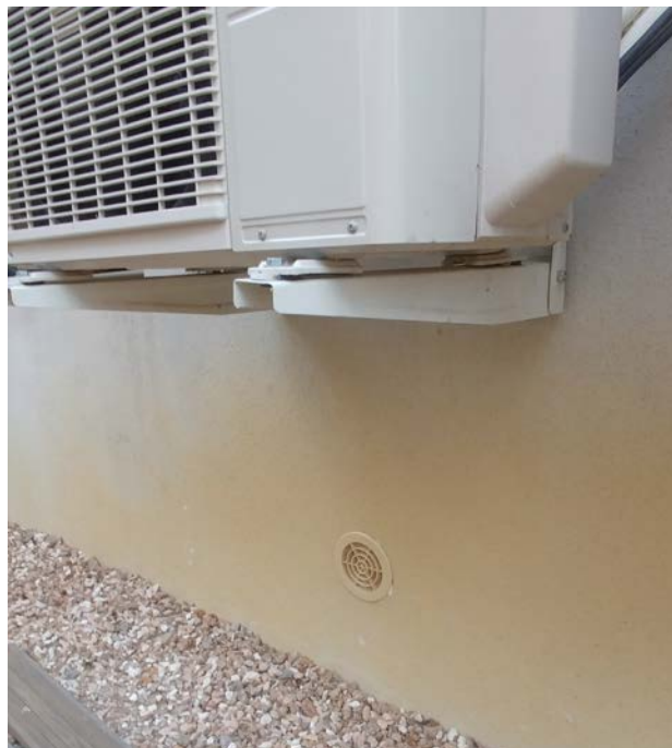
Unité extérieure suspendue sur un support de niveau. © AFF.
